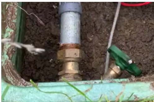
Photo 4 Vanne d'arrivée d'eau principale
